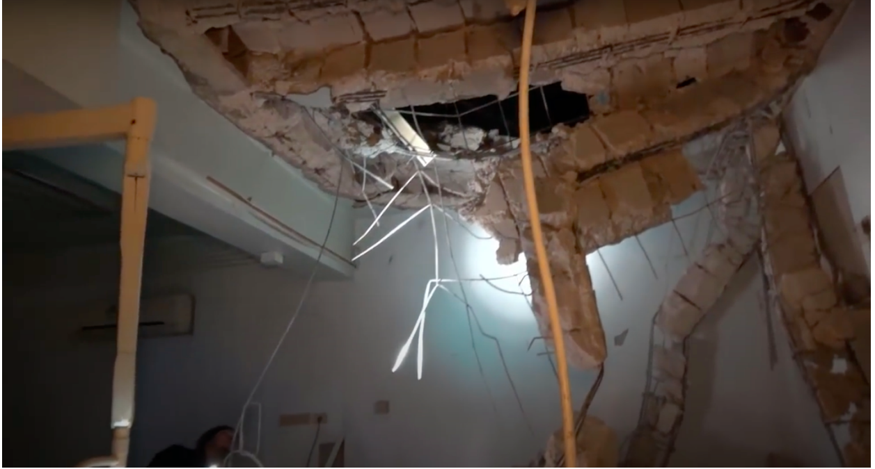
حفرة في سقف مشفى معرة النعمان الوطني نتيجة ضربة جوية من قبل القوات الروسية.
